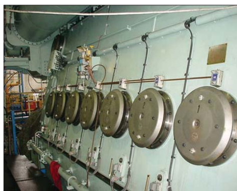
Slika 6. „Hoerbiger“ sigurnosni ventil instalirani na karтеру sporohodnog brodskog 2-t motora
